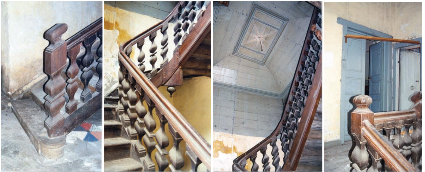
Escalier , rampe sur rampe XVIII e siècle, cage en lambris peints , portes et menuiseries d'origine.
