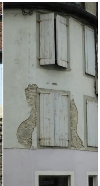
Défaut d'entretien de l'enduit et dégradation de la maçonnerie.
