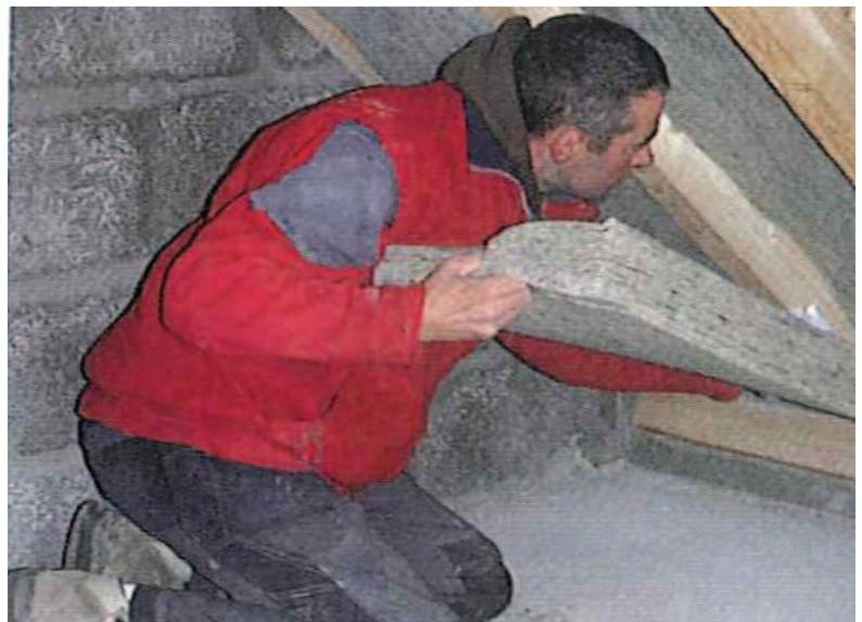
Principe de l'isolation des combles praticables. Pose d'isolent entre chevrons sous la couverture. Source : L'isolation thermique écologique, Oliva et Cougey, 2010.
