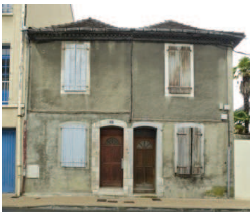
Enduit imperméable au ciment et traces d'humidité sur la façade.
