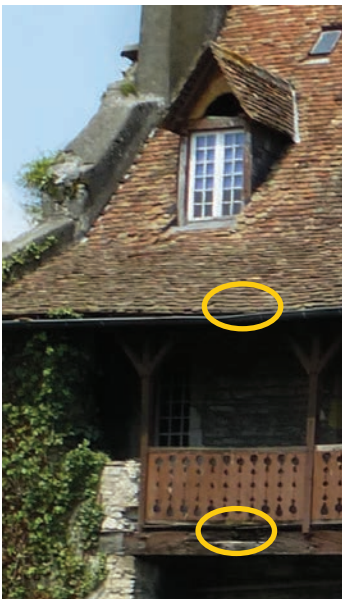
Défaut d'entretien de la gouttière et mise en péril de la structure de la galerie.
